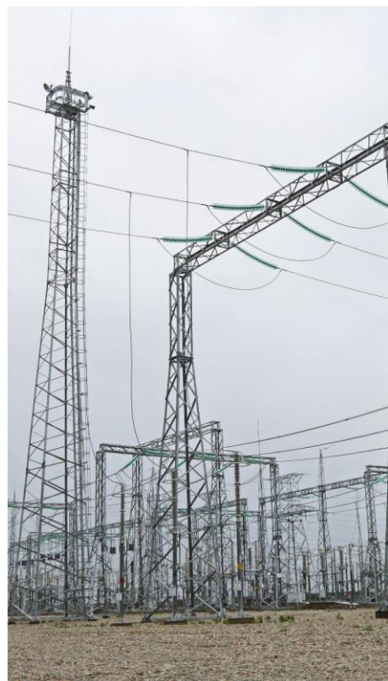
Электросетевой энергомоcт полуостров Крым
