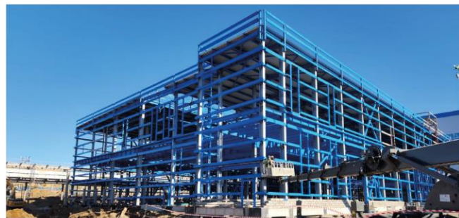
Южно-Якутская ТЭС 420 тн
